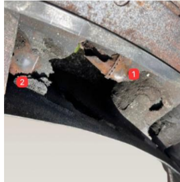
Fig. 5. Detalle de la zona con daño severo.
